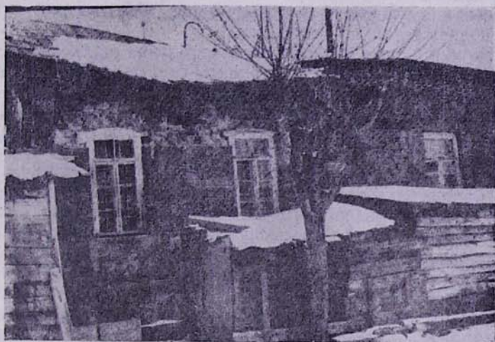
Рис. 3. Обвал наружного слоя облицовки кладки на глиняном растворе (улица № 39, дом № 243)
