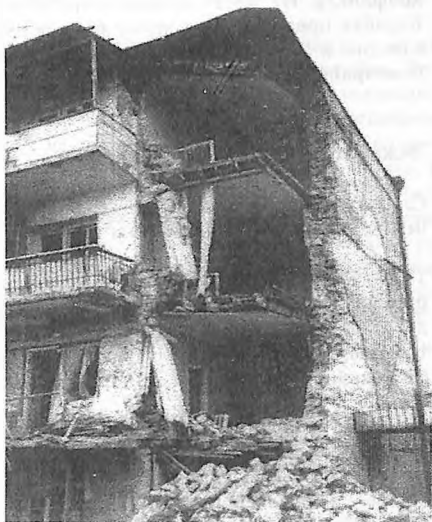
Жилой дом в Степанакерте, разрушенный азербайджанскими ракетами "Град" (СШ).
