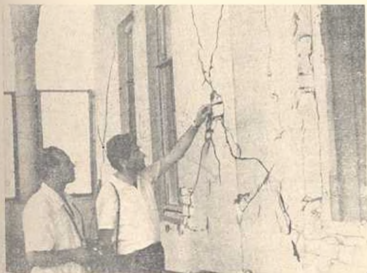
Рис. 2. Характер разрушения стен верхнего этажа углового отсека жилого дома по ул. Навои, 21 при ташкентском землетрясении 26 апреля 1966.
