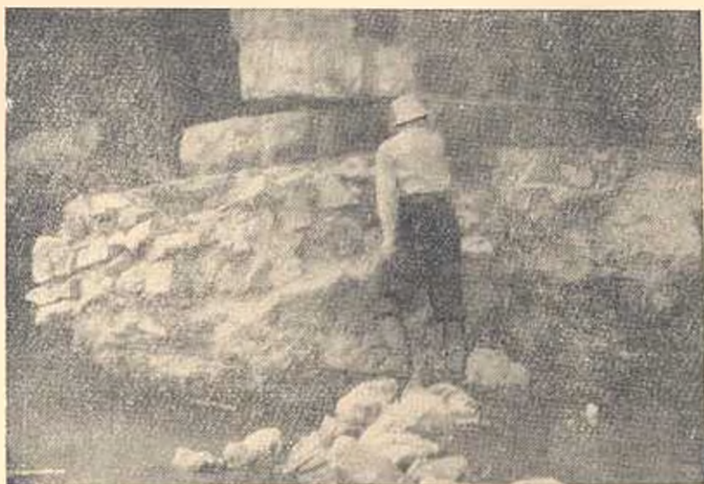
Рис. 5. р. Дзнкагел. Обнаженная и разрушенная опора моста на шоссейной дороге.
