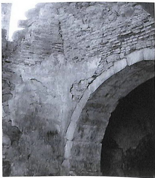
Остатки плинфowego свода первого зала трапезной
