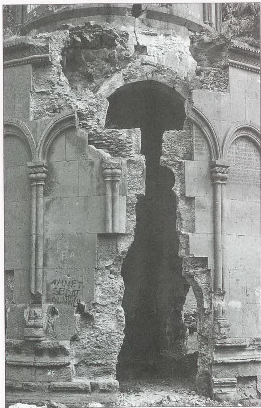
Fig. 8. Saint-Serge. Brèche de la conque sud; voûte et toit effondrés (2013).
